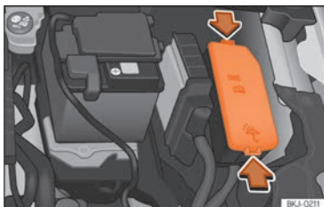
Fig. 170 Al compartiment del motor: tapa de la caixa de fusibles.
